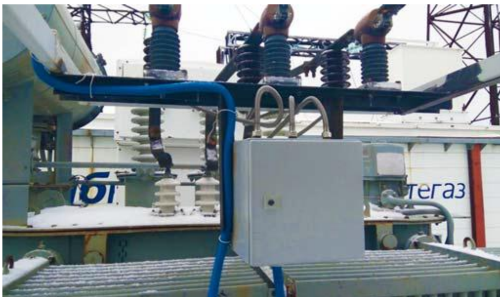
Рисунок 2. - Пример ПКУ на базе цифровых измерительных трансформаторов 6(10) кВ производства ООО НПО «ЦИТ»: 1-комбинированные первичные преобразователи цифровых измерительных трансформаторов; 2-шкаф с электронным преобразователем и счетчиком электрической энергии
