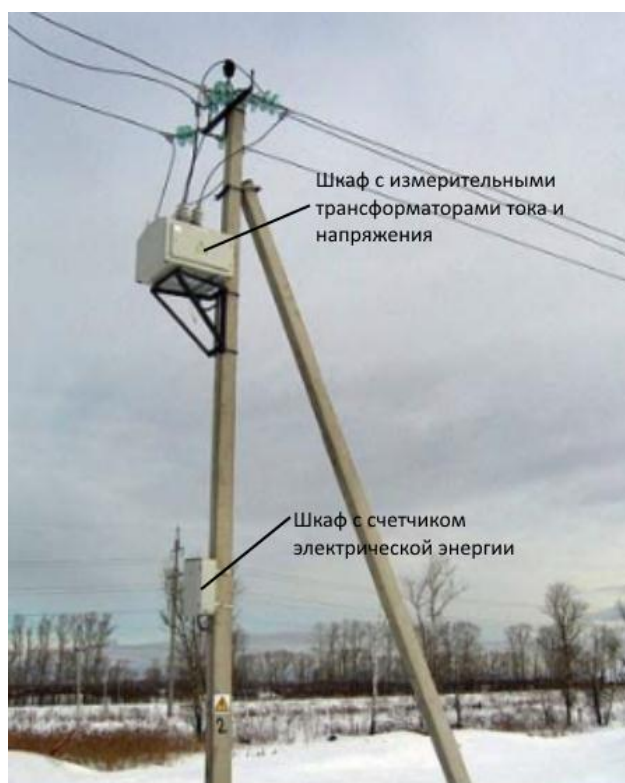
Рисунок 1. - Традиционный ПКУ, установленный на опоре линии электропередачи (ЛЭП)
