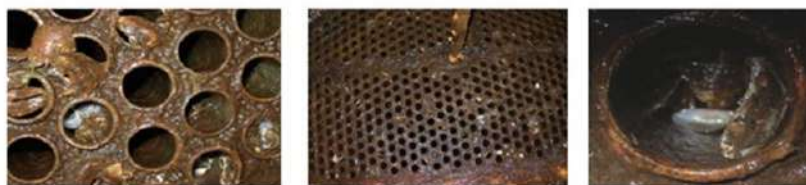
Рис. 2. Трубки конденсаторов турбины Казанской ТЭЦ-1 после промывки, забитые моллюском дрейссена
